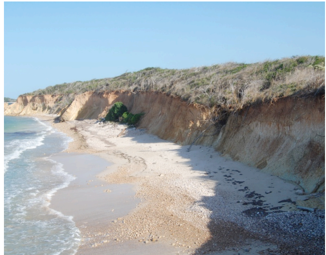
Foto 27. Estación No. 6. Formación de playa arcillosa por erosión y desprendimiento de material.
