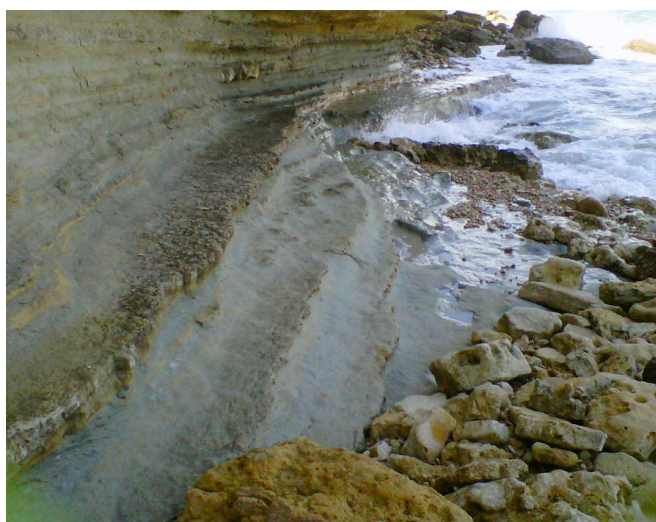
Foto 7. Capas erosionadas de la base del acantilado. Playita de El Morro.
