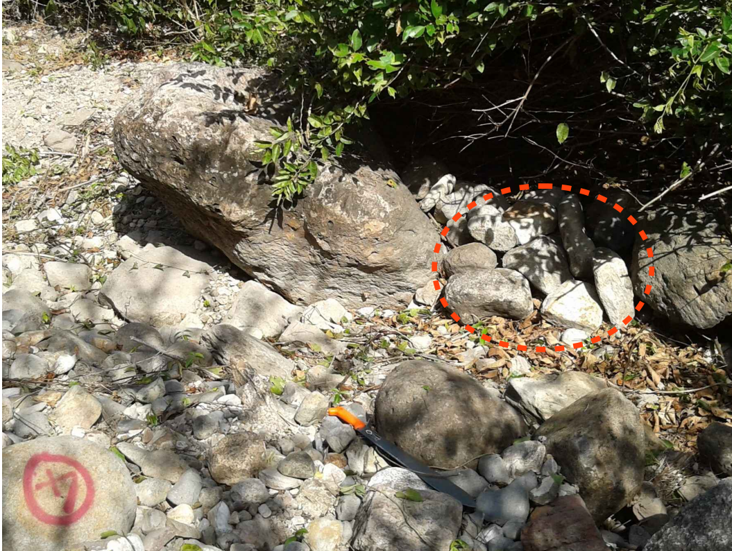
Ilustración 11: Ejemplo de protección hidráulica en remplazo de la vegetación podada.
